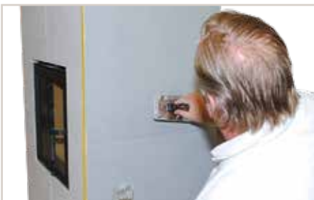
Nach dem Antrocknen wiederholt in kreisenden Bewegungen mit der gesamten Kellenfläche über die Oberfläche streichen.
